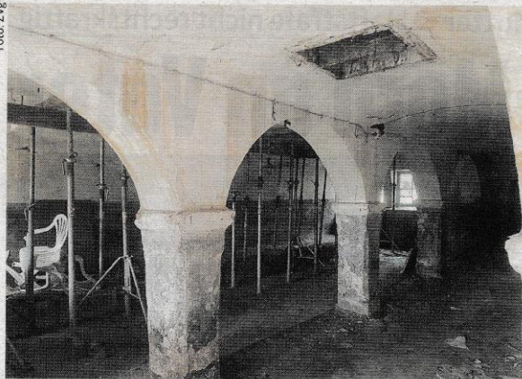
Gewölbe im großen Stall – einige Investitionen wären nötig
